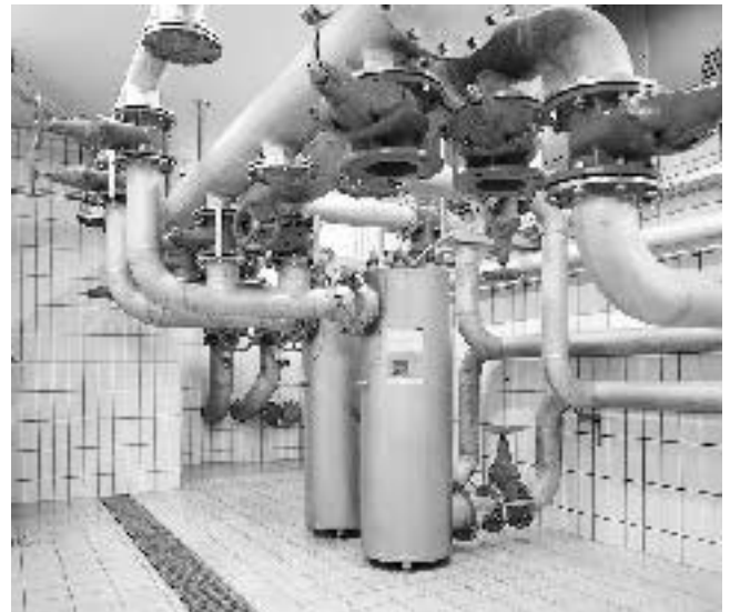
Fig. 3 - Desinfección mediante radiación ultravioleta en ACS
