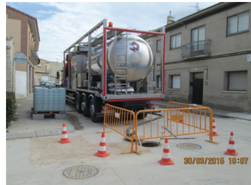
Figura 4. Sistema de limpieza Ice Pigging. Agua con manganeso
